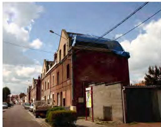
Cette maison, rue de la Résistance était vacante depuis plusieurs années. Elle est en cours de réhabilitation par le PACT Métropole Nord.
